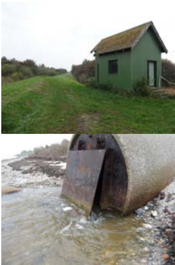
Figur 3.4.1: Pumpestationen og udløbets kontraklap, som udskiftes.
