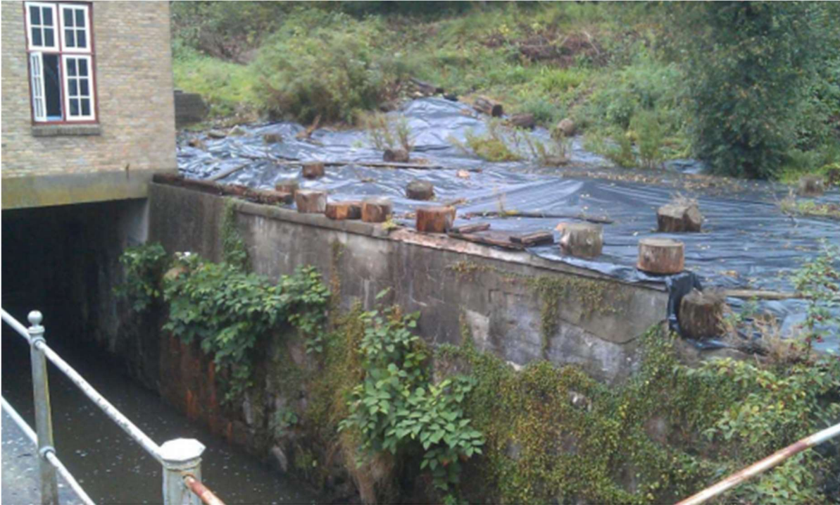
Japansk pileurt der er vokset gennem betonmur.
