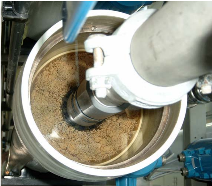
Figur 14.4. Ultrafiltreringsanlæg med hulfibermembraner til behandling af svømmebadsvand
