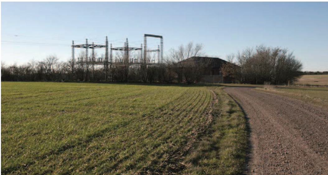
Figur 3: Eksisterende transformatorstation på Lille Ulfkærvej.
