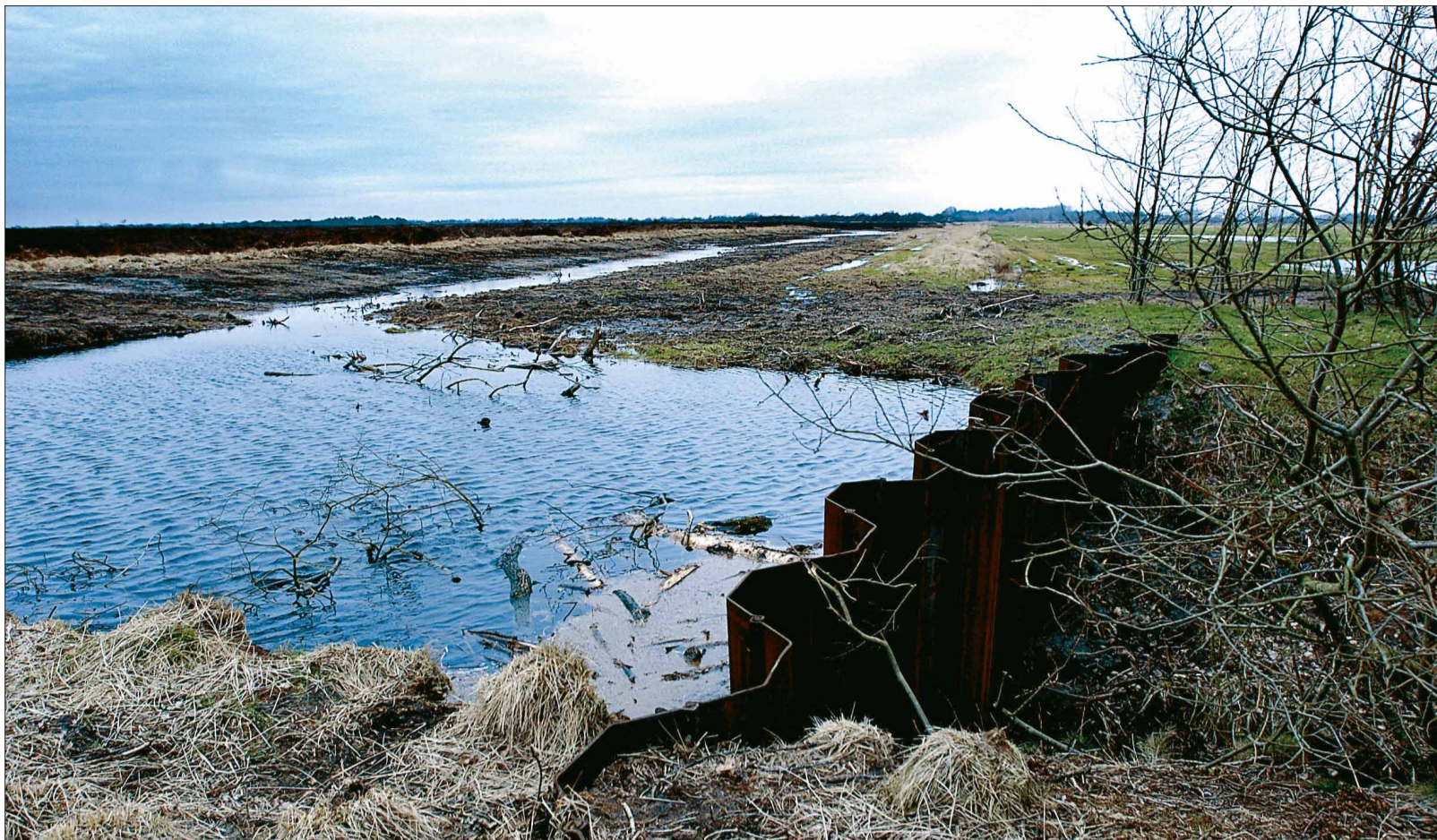
Indtil videre er der sat fem spunsvægge ned i grøfterne i Kongens Mose, og der skal et par stykker op mere endnu. De er med til at holde vandet inde i mosen og dermed hæve vandstanden. FOTO: HANS CHRISTIAN GABELGAARD
