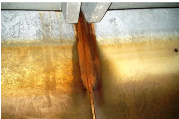
Billede af en af lækagerne i den relativt nye, men utætte rentvandstank.
