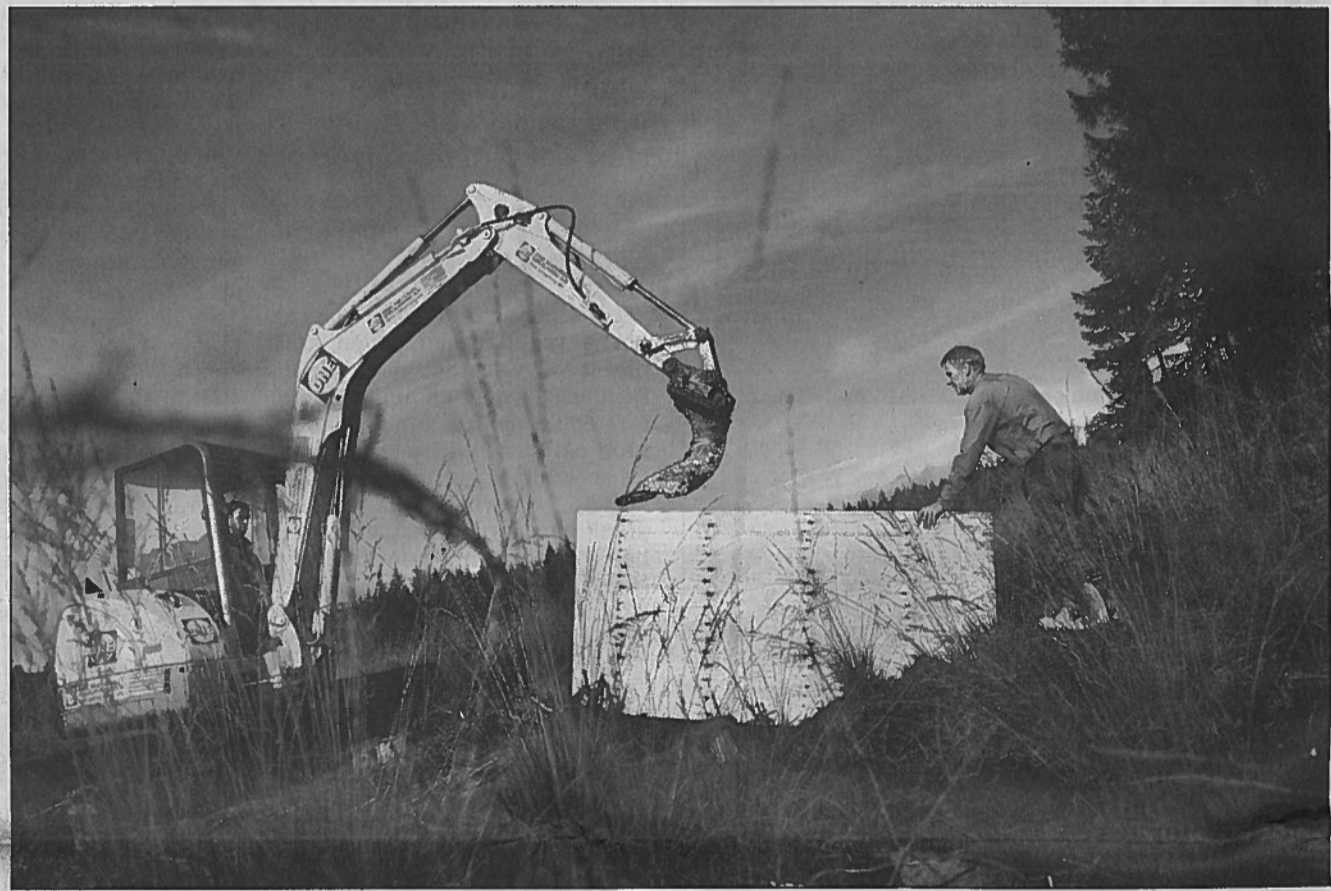
For at fremme væksten af spagnummosser skal vandstanden hæves. Det sker ganske enkelt ved at denne maskine laver riller på tværs af afvandingsgrøfterne, der så spærres med træplader. - Foto: Martin Sylvest
