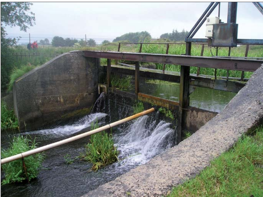
Figur 4. Stemmeværket ved Rens Dambrug med gangbro, ungfiskesluse og ålepas. Den eksisterende fisketrappe (kammertrappe) anes til venstre på billedet.
