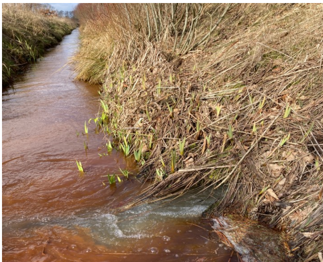
St. 3245 Ø30 rørtilløb der afvander et større område mod nordøst
