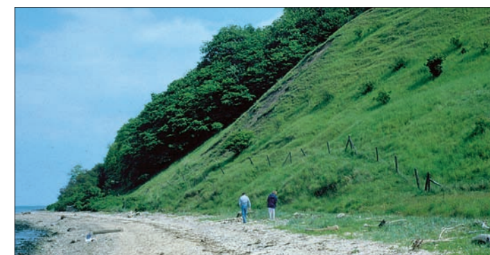
Kystskrænten vest for parkeringspladsen ved Røjle Klint
