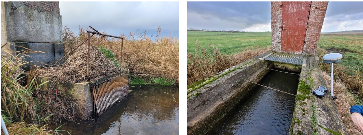
Figur 4.8: Pumpehuset ved afløbet fra Skadekær. Venstre: indløbet til pumpekamrene, hvor der findes et risteværk til opsamling af grøde. Højre: afløbet fra pumpehuset til afløbskanalen mod Vandet Sø.
