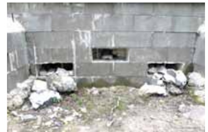
Foto 82. Anlæg af 'tudsehotel' i fundamentet under en lade. Der er gravet en grube, som er fyldt op med sten. Indgang gennem muren til højre. Saltholm 2009. Foto Niels Damm.
